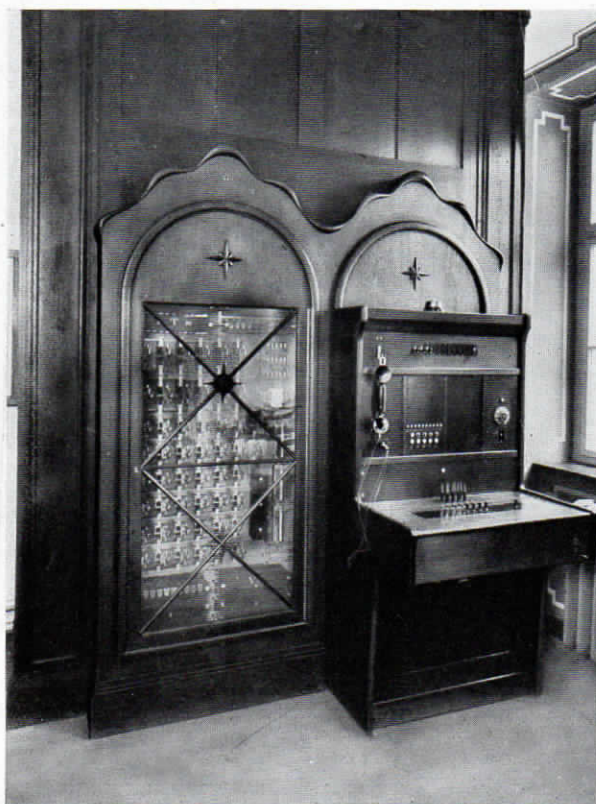
„Priteg“ Glühlampen Zentrale für den Amtsverkehr und vollautomatische „Priteg“ Hauszentrale in der Spezialnähmaschinenfabrik Julius Köhler in Limbach.
