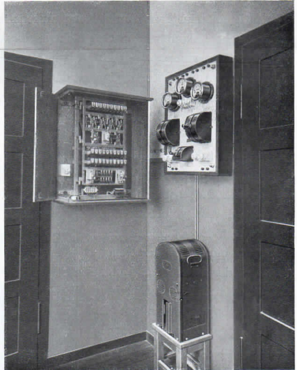
„Priteg“-Automatenzentrale nach dem 10er System sowie Ladeeinrichtung und Gleichrichter, aufgestellt im Stadtschultheißenamt Plochingen.
