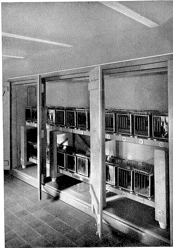
Abb. 32. Akkumulatorenbatterie in Wandschrank eingebaut, im St.-Bernwards-Krankenhaus in Hildesheim.
