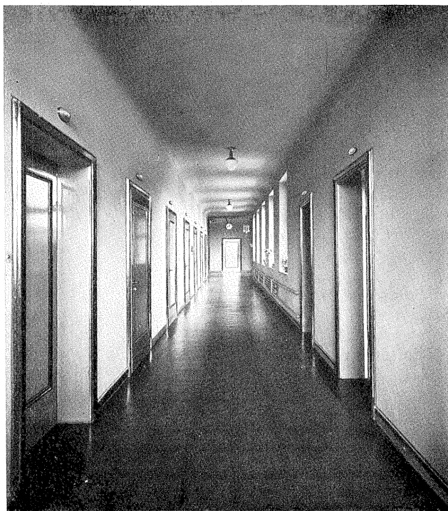
Abb. 53. Flur mit Priteg-Lichtruf- und Suchanlage sowie Normalzeit-Nebenuhr im Stadt-Krankenhaus Osnabrück.
