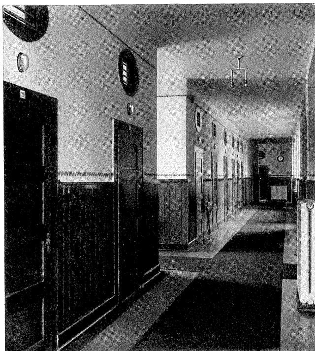
Abb. 25. Flur mit Priteg-Lichtruf- und Suchanlage sowie Normalzeit-Nebenuhr im Badehaus in Bad Salzuflen.
