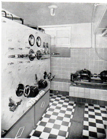
Abb. 14. Ladeschalttafel und Ladeumformer für die Batterieanlage
