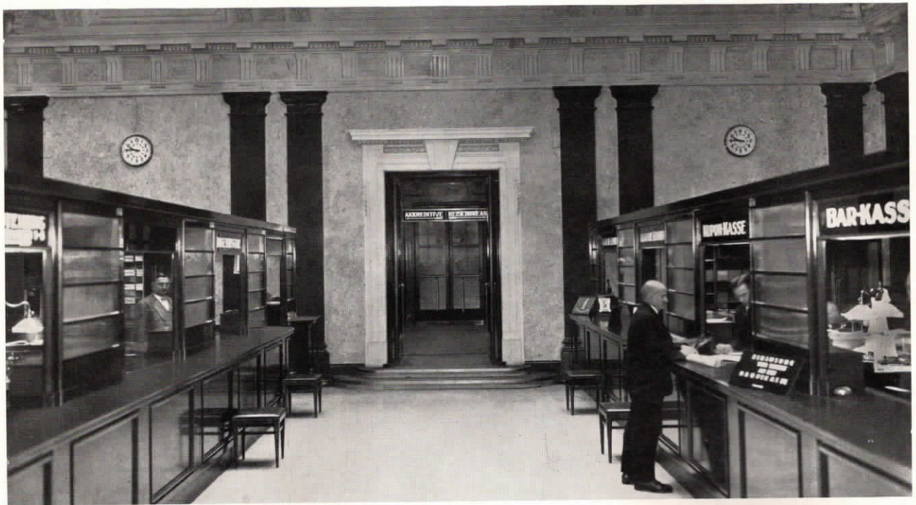
Abb. 7. Elektrische Normalzeit-Einbau-Uhren in einem Schalteraum der Dresdner Bank in Berlin.
