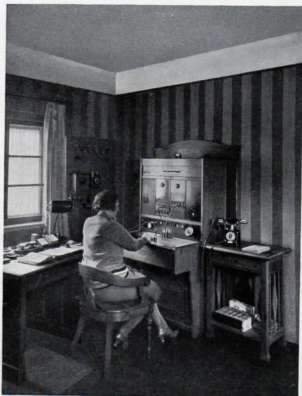
Abb. 1: Halbautomatische Fuld-Fernsprechzentrale für 5 Amtsleitungen und 40 Nebenstellen in der Schlesischen Portland-Cement-Industrie A. G. Oppeln
