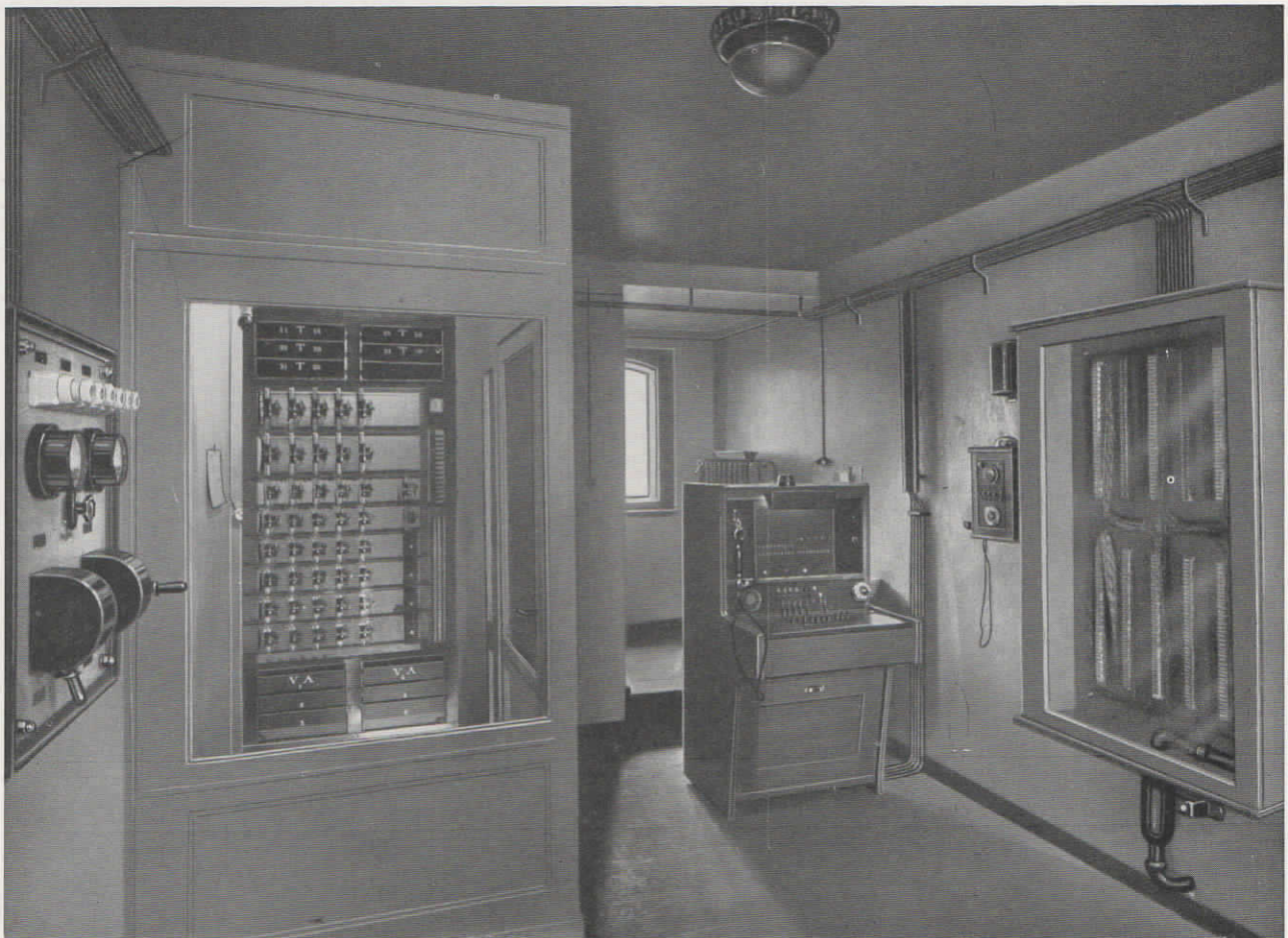
Abb. 19: Fuld-Glühlampenzentrale für 4 Amtsleitungen, 30 Nebenstellen und 5 außenliegende Nebenstellen, ferner vollautomatische Fuld-Hauszentrale für 50 Teilnehmer, sowie Rangierverteiler, Prüfschrank und Ladeschalttafel im Landratsamt Leobschütz
