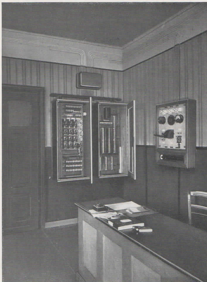
Abb.10: Vollautomatische Fuld-Fernsprechzentrale für 25 Teilnehmer (geöffnet), Rangierverteiler (geöffnet) und Ladeschalttafel in der Schultheiß-Patzenhofer-Brauerei A.-G., Abt. Oppeln O/S.
