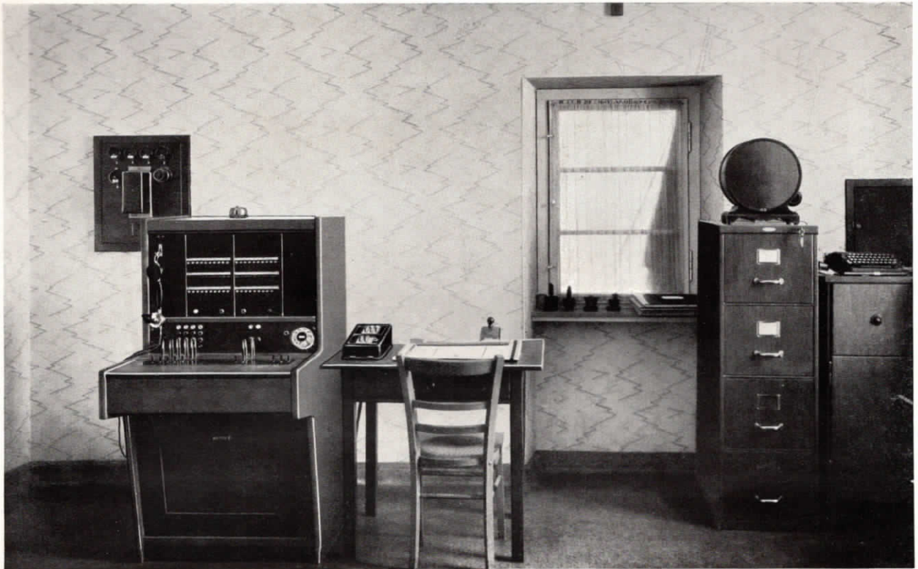
Abb. 2. Fuld-Glühlampenzentrale, sowie Einschaltastatur für die Lichtrufanlage im Krankenhaus der Barmherzigen Brüder zu Regensburg (Männerbau).
