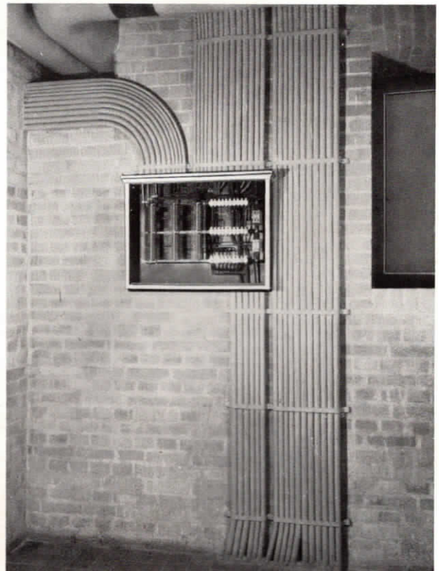
Abb. 33. Rohrleitungen und Zwischenverteiler in der Frauenklinik und Säuglingsheim in Nürnberg.
