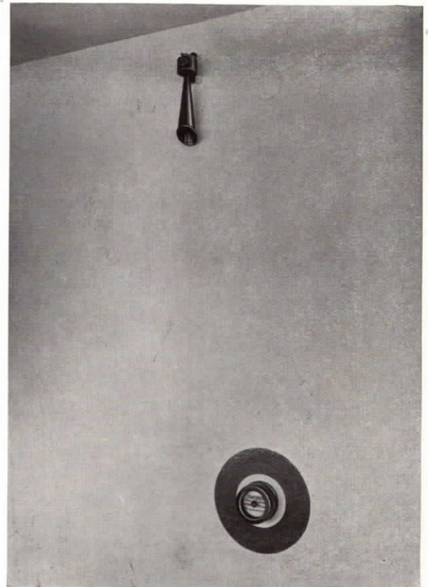
Abb. 9. Feuermelder und Alarmhupe auf einem Flur.
