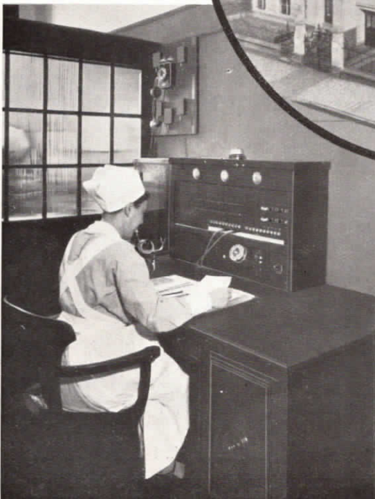
Abb. 28. Fuld-Glühlampenzentrale für 2 Amtsleitungen und 20 Nebenstellen mit selbsttätiger Trennung im Luise-Krankenhaus in Düsseldorf.
