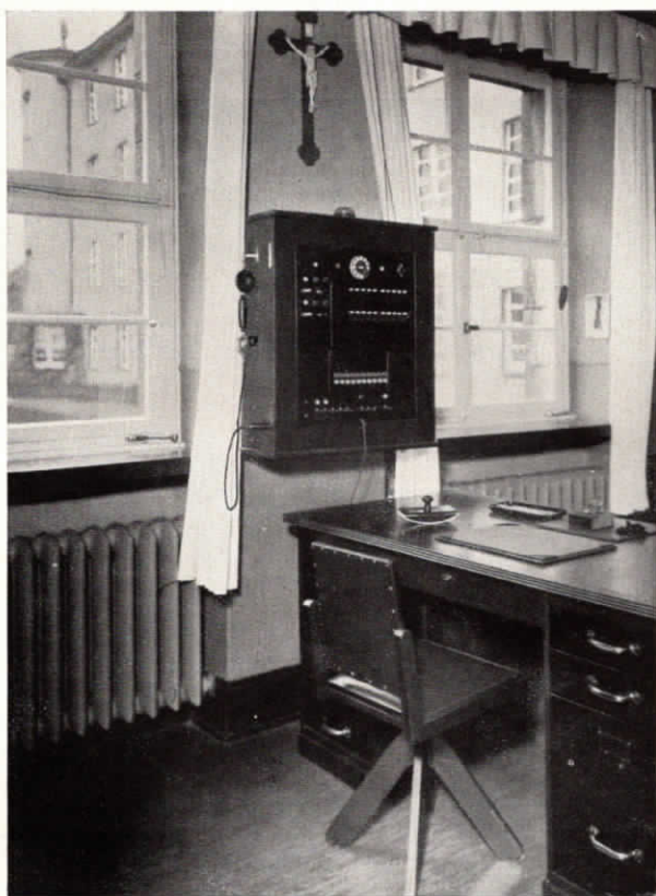
Abb. 88. »Fuld«-Druckknopf-Wandzentrale für 2 Amtsleitungen und 20 Nebenstellen (dem internen Verkehr dient eine vollautomatische Hauszentrale für 25 Teilnehmer) im Städtischen Krankenhaus in Attendorn.
