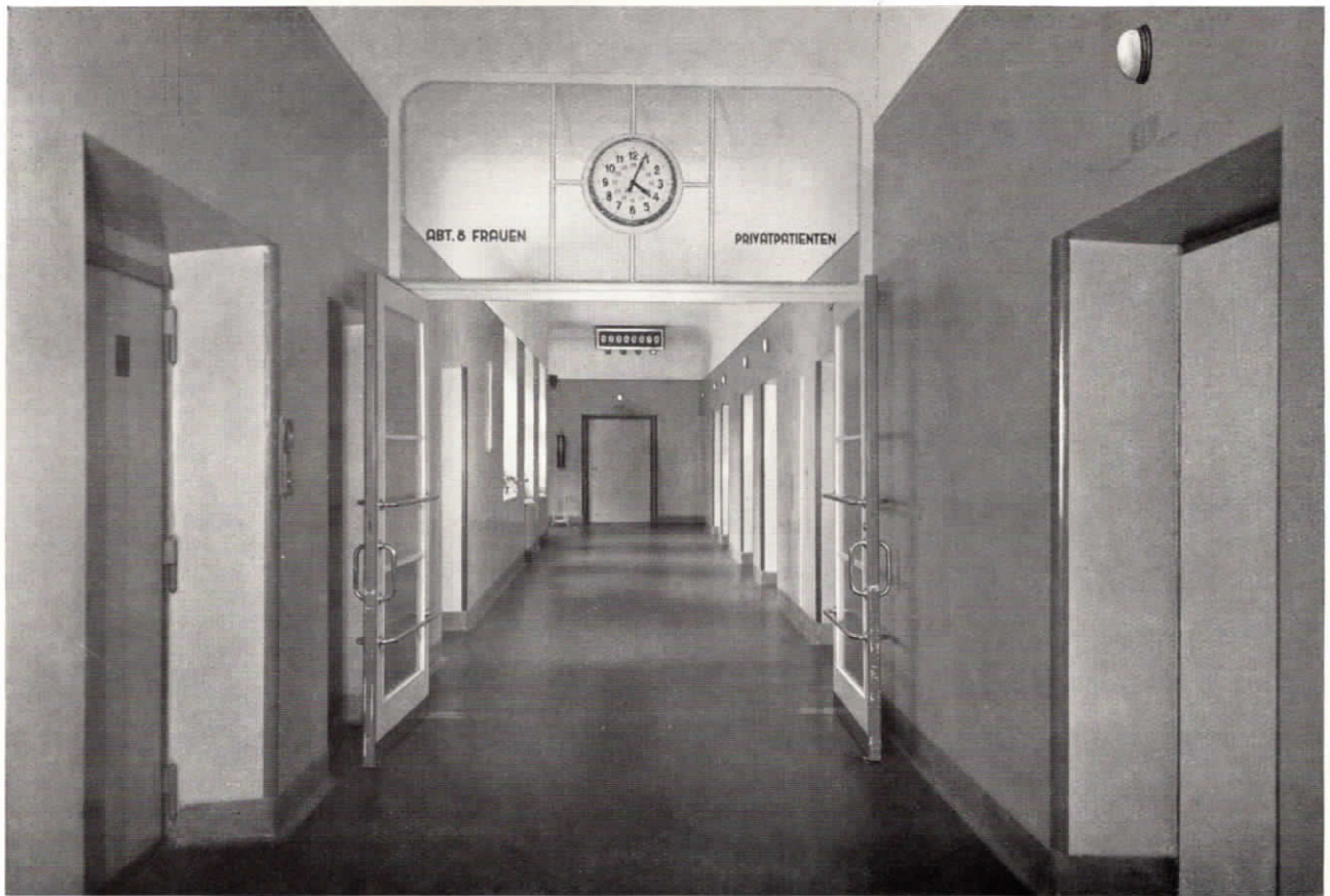
Abb. 96. Flur im Bezirkskrankenhaus Ludwigsburg. Das Krankenhaus verfügt über eine ausgedehnte »Fuld«-Fernsprechanlage, bestehend aus einer Reihenanlage mit vollautomatischem Hausverkehr für 40 Teilnehmer. Die Lichtsignalanlage umfaßt 96 Zimmer; die elektrische Uhrenanlage 1 Hauptuhr und 11 Nebenuhren.
