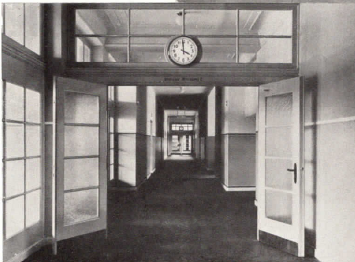
Abb. 41. Flur in der Städtischen Krankenanstalt Bremen mit Lichtsignal-Zimmerlampen über den Türen, Lichtsignal-Armatur an der Decke und doppelseitigen Normalzeit-Nebenuhren.
