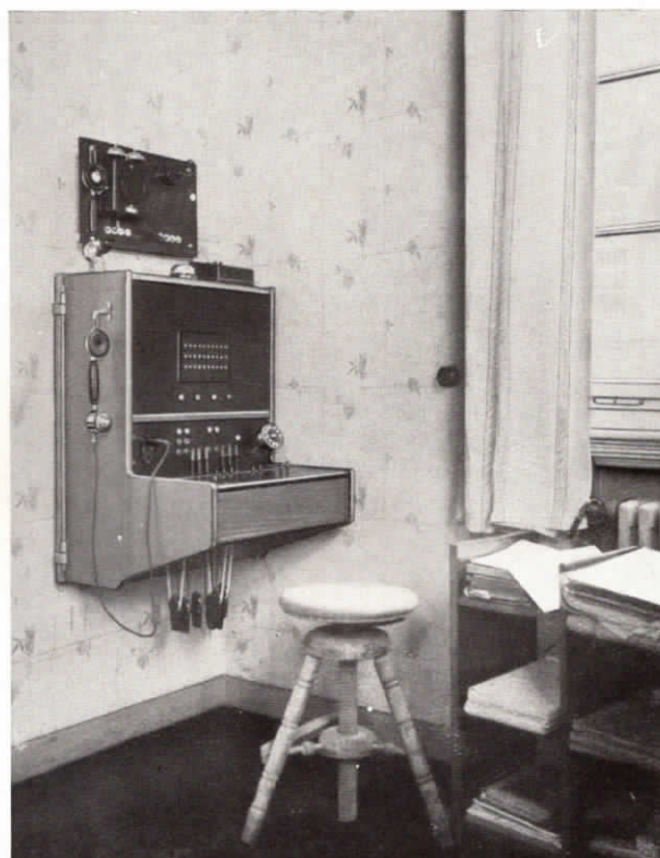
Abb. 73. »Fuld«-Glühlampenwandzentrale für 2 Amisleitungen und 20 Nebenstellen; den internen Verkehr vermittelt ein »Fuld«-Hausautomat für 23 Teilnehmer, im Städtischen Krankenhaus in Wilhelmshaven.
