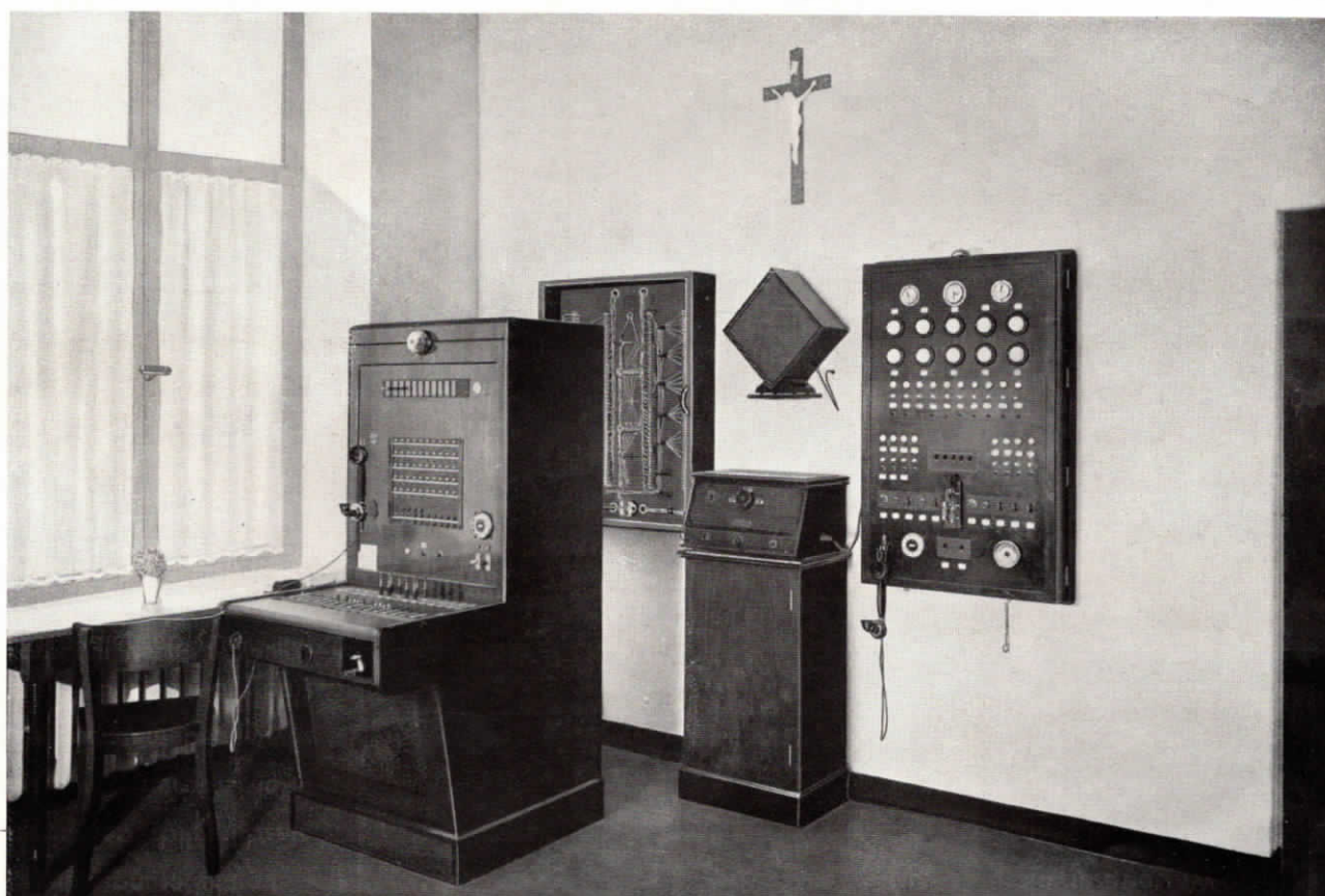
Abb. 102. Manuelle Zentrale mit Rangierverteiler, ferner Gruppen- und Überwachungstablo für die Fernmeldeanlage, sowie Radioanlage im St. Theresien-Krankenhaus in Nürnberg.
