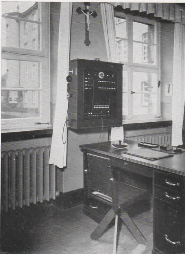
Abb. 63. »Fuld«-Druckknopf-Wandzentrale für 2 Amtsleitungen und 20 Nebenstellen (dem internen Verkehr dient eine vollautomatische Hauszentrale für 25 Teilnehmer) im Städtischen Krankenhaus in Attendorf
