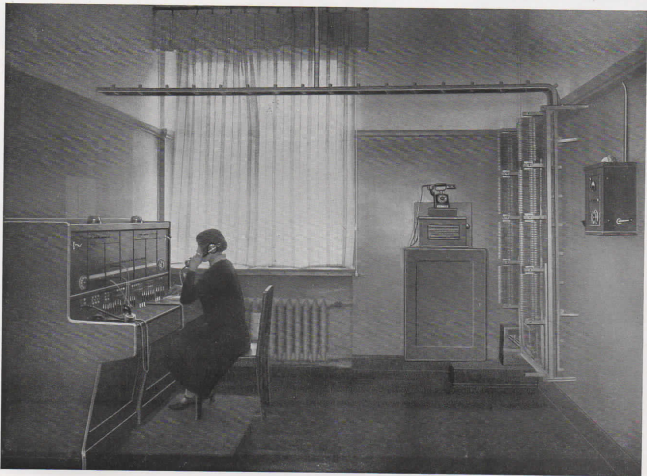
Abb. 53. Zweiplätziger Bedienungsschrank der halbautomatischen Fuld-Nebenstellen-Zentrale des Barmer Bankvereins in Wuppertal-B.; rechts Hauptverteiler mit Prüfeinrichtung
