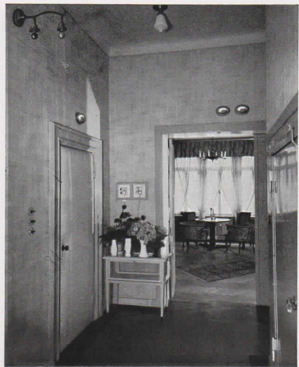
Abb. 52. Flur mit Zimmerlampen, Lichtsignalarmatur und Fernsprechapparat in der Privatklinik Dr. med. Alois Knotte, Essen
