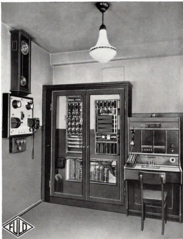
Abb. 5. Fernsprech-Zentralenraum in der Girozentrale Sachsen in Plauen mit halbautomatischer Fuld-Nebenstellen-Zentrale für 4 Amtsleitungen, 16 Nebenstellen und 9 Hausstellen, vollautomatischer Fuld-Hauszentrale für 25 Teilnehmeranschlüsse, Einschaltetastatur für die Lichtrufanlage, Ladeschalttafel und Normalzeit-Hauptuhr
