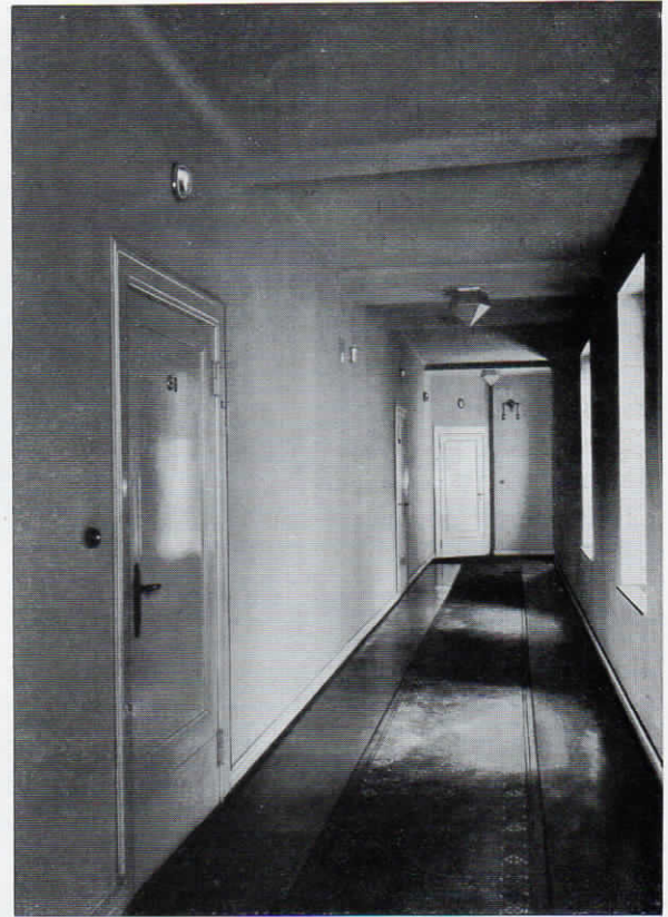
Abb. 72. Flur im „Hotel Excelsior“ in Bremerhaven mit Fuld-Lichtsignalarmaturen (Zimmerlampen über den Türen und Signalarmatur im Hintergrund). Die Fuld-Lichtsignalanlage umfaßt 117 Zimmer und dient zum Rufen des Bedienungspersonals.
