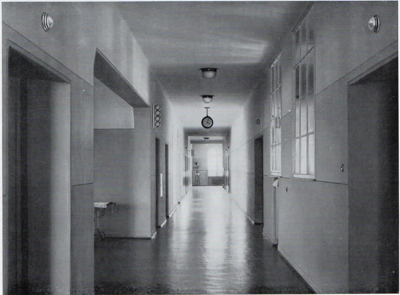
Abb. 114. Flur mit Fuld-Lichtsignalarmaturen im Kreiskrankenhaus in Nordhorn. Die Lichtsignalanlage erstreckt sich auf 32 Krankenzimmer.
