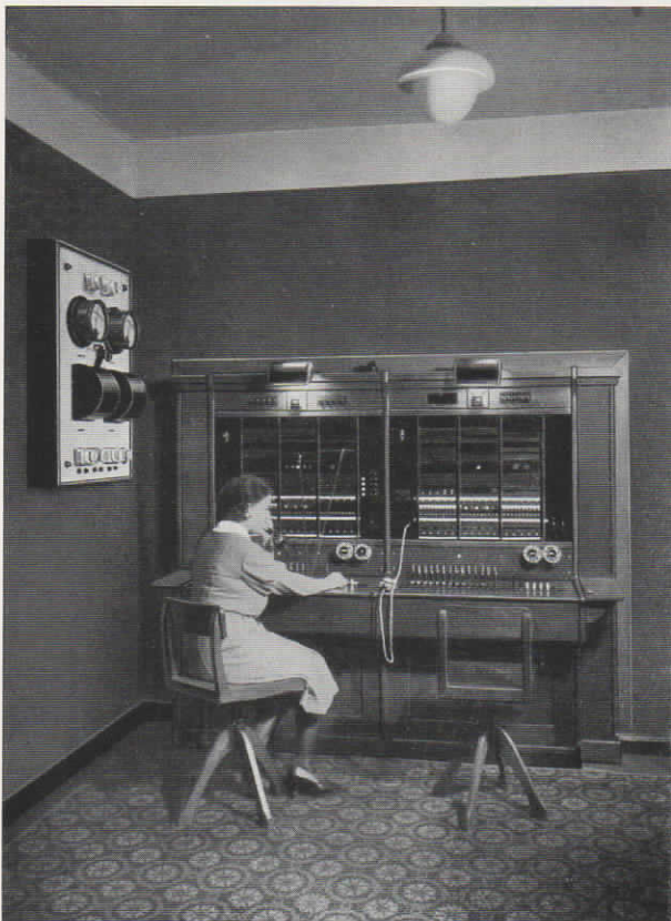
Abb. 25. Fuld-Glühlampenzentrale mit 2 Arbeitsplätzen, 30 Amtsleitungen, 80 Nebenstellen und 30 Querverbindungen.
