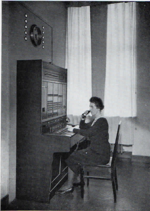
Abb. 101. Fuld-Vorschaltschrank für 12 Amtsleitungen und 130 Nebenstellen
