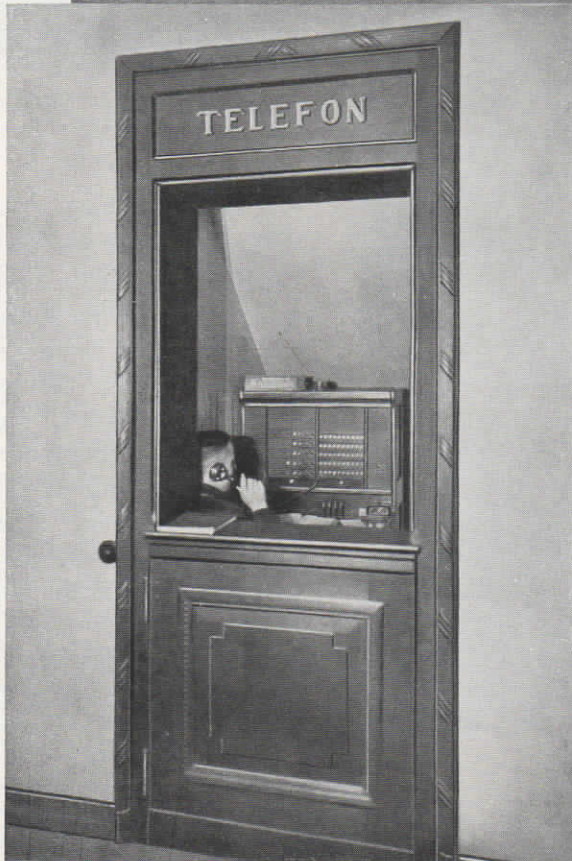
Abb. 58. Blick auf die Fernsprech-Zentrale im Vestibül. Eine Fuld-Glühlampenzentrale für 5 Amtsleitungen u. 50 Nebenstellen ist für den Gästeverkehr bestimmt, während eine vollautomatische Zentrale dem internen Verkehr dient.
