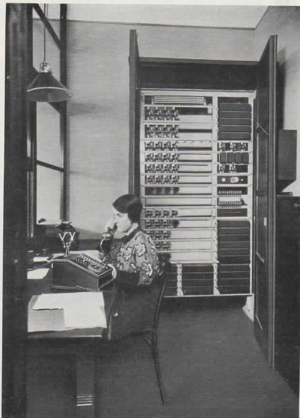
Abb. 30. Die fernmeldetechnische Einrichtung in der „Nordstern“-Versicherungs-Aktiengesellschaft, Filial-Direktion, Bremen besteht aus einer Fuld-Universalzentrale für 4 Amtsleitungen und 30 Teilnehmeranschlüssen und einer Personenrufanlage für 10 Personen.
