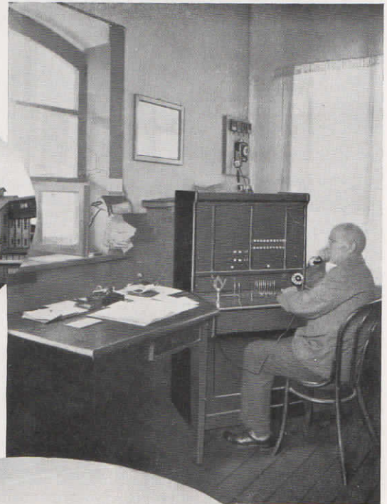
Abb. 30 (rechts). Fuld-Glühlampenzentrale für 2 Amtsleitungen und 20 Nebenstellen.
