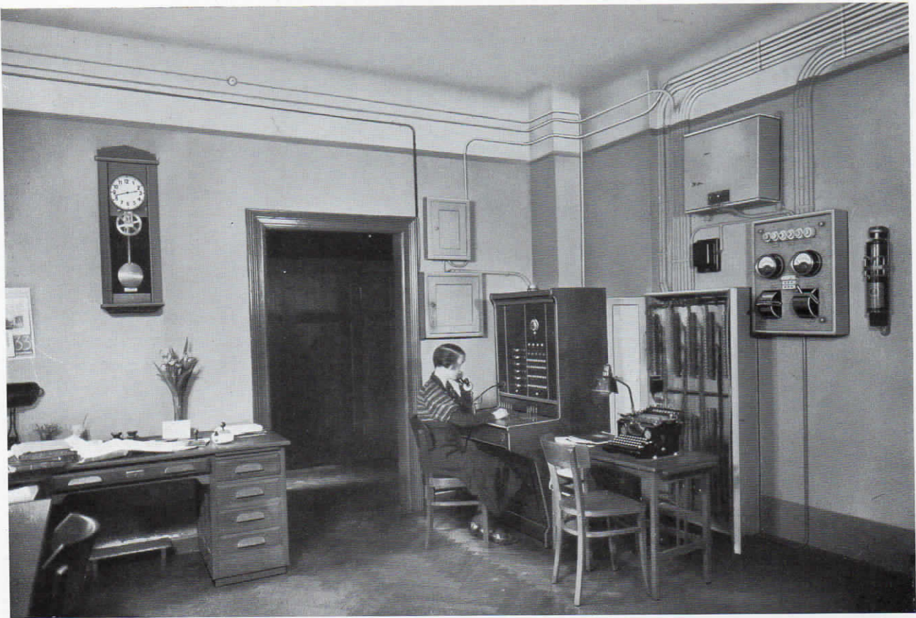
Abb.11. Blick in den Fernsprechzentralenraum mit Fuld-Glühlampenzentrale, geöffnetem Rangierverteiler, Ladeeinrichtung und Elektrozeit-Signal-Hauptuhr in der Braunschweigischen Landeszeitung.
