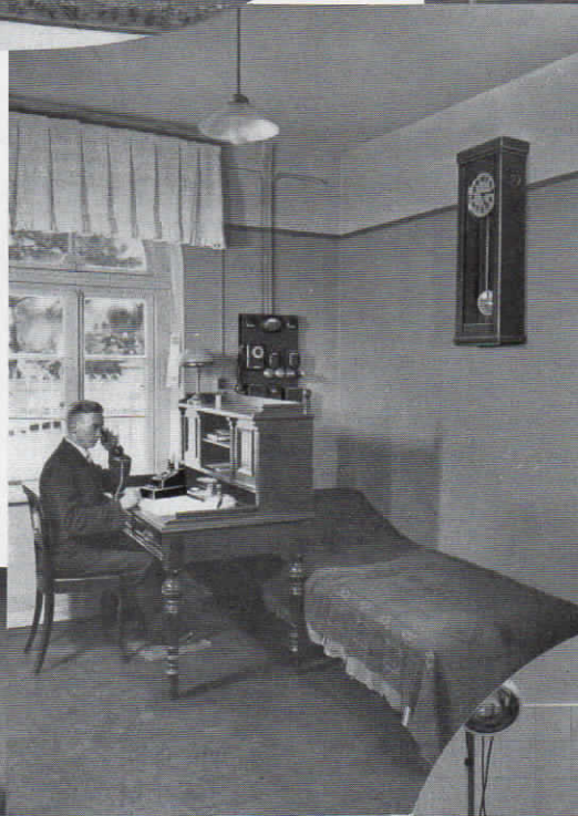
Abb. 64 (rechts). Portier-Zimmer mit Fuld-Fernsprecher und Elektrozeit-Hauptuhr in der Landesfrauen-Klinik in Celle. Die Fernsprechanlage besteht aus 15 Fuld-Fernsprech-Reihenapparaten über 2 Amtsleitungen. Eine vollautomatische Fuld-Hauszentrale 50er System dient dem Untereinanderverkehr.
