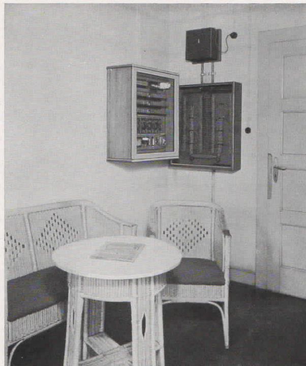
Abb. 25. Wartezimmer mit vollautomatischer Fuld-Hauszentrale für 23 Teilnehmer, ferner Rangierverteiler und Ladegerät in der Maschinenfabrik H. Wohlenberg Komm.-Ges. in Hannover.
