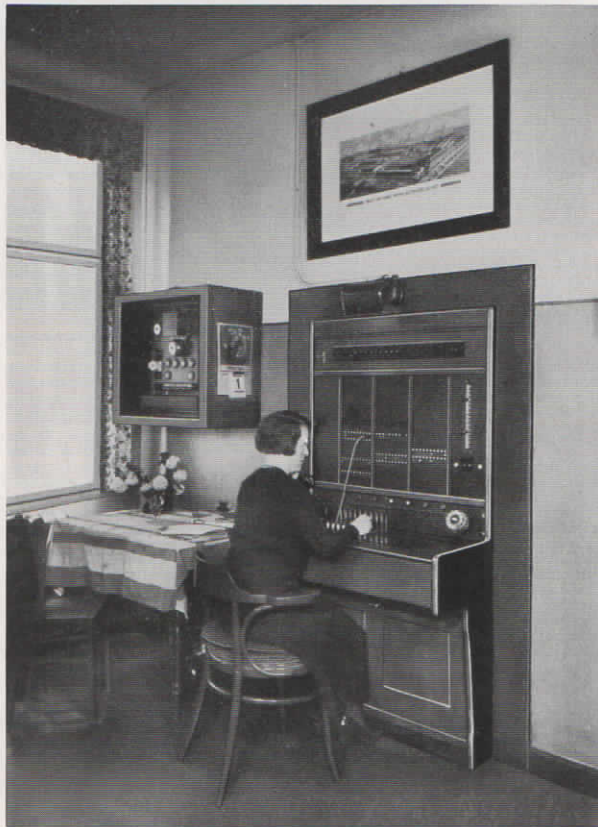
Abb. 19. Die halbautomatische Fuld-Fernsprechzentrale für 10 Amtsleitungen und 90 Nebenstellen in der Hackethal Draht- und Kabelwerke Akt.-Ges. in Hannover.
