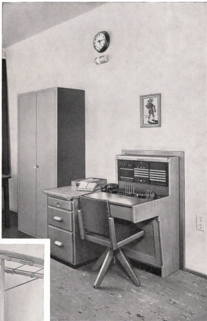
Bild 5 Vermittlungsschrank der Fernsprech-Nebenstellenanlage II G nach dem Rekord-System
