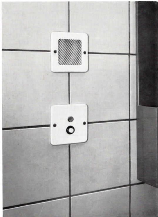
SPRECHANLAGE DER BÄDERABTEILUNG
