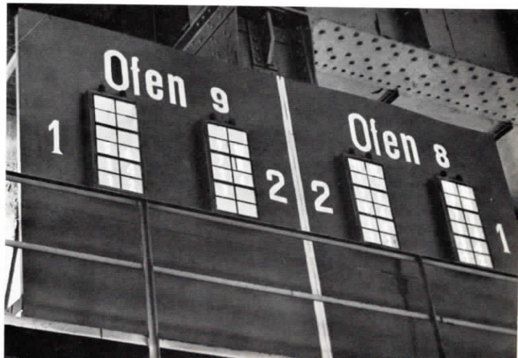
BILD 2 LICHTSIGNALANLAGE DER TIEFOFEN
