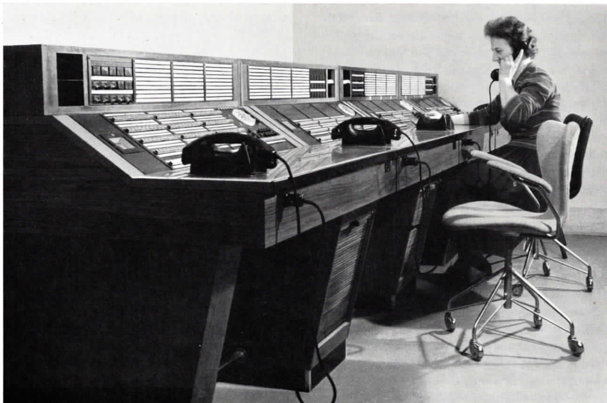
FERNSPRECHVERMITTLUNG DER BAUSTUFE III W MIT VIER ARBEITSPLÄTZEN
