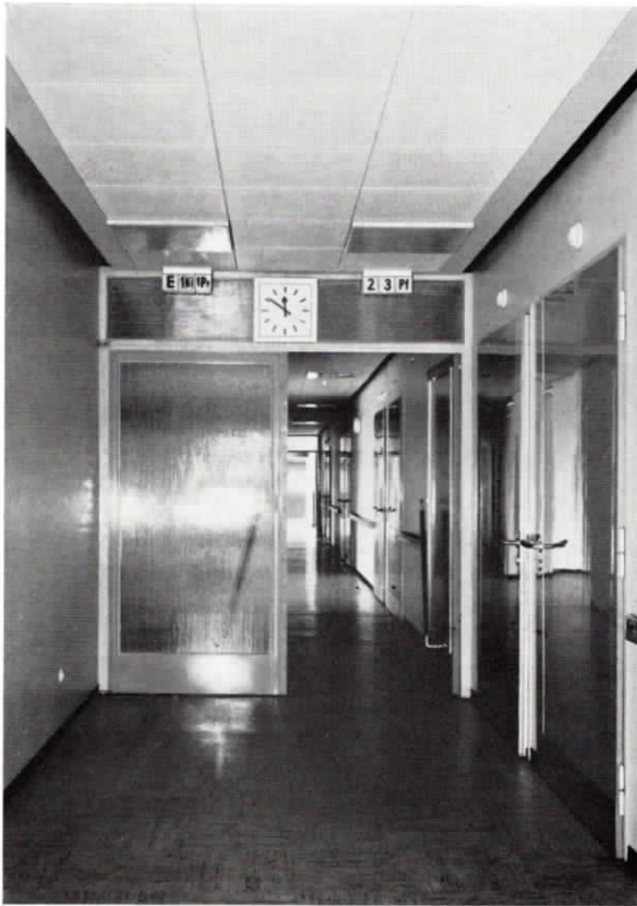
PERSONEN-SUCHANLAGE IN EINEM KORRIDOR
