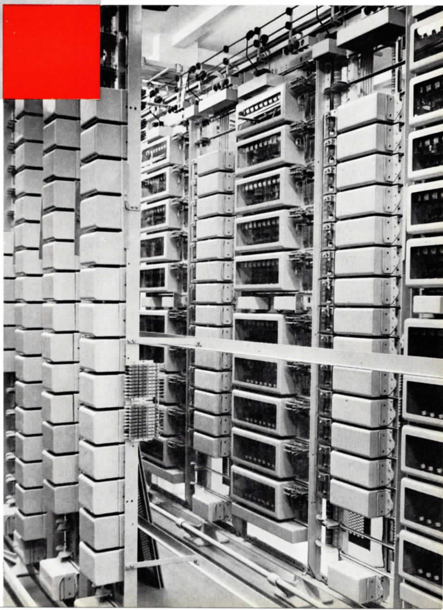
BLICK AUF EINE GESTELLREIHE MIT VORWÄHLERN UND LEITUNGSWÄHLERN
