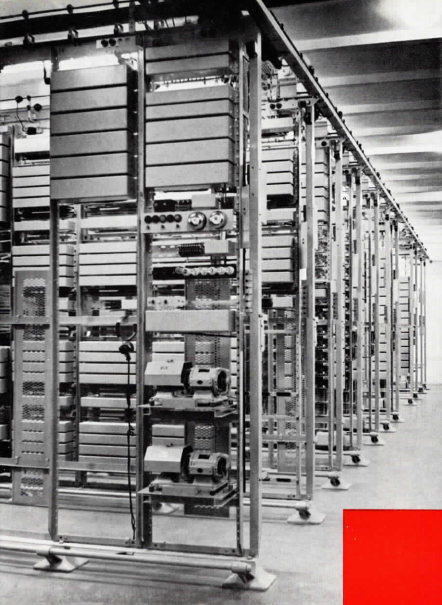
TEILANSICHT DES GROSSEN WÄHLERSALES
