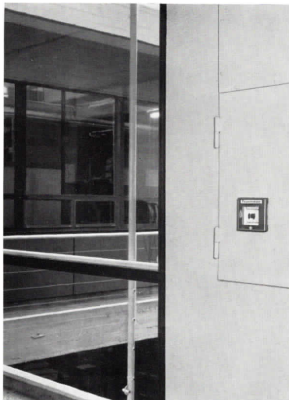
BILD 6 Feuermelder im Treppenhaus
