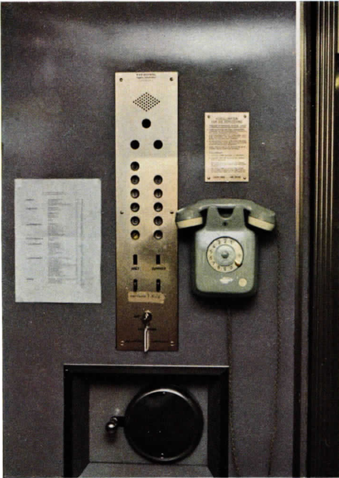
BILD 3 Fernsprechapparat im Aufzug
