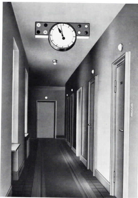
BILD 7 Lichtruf-Anlage in einem Krankenhaus
