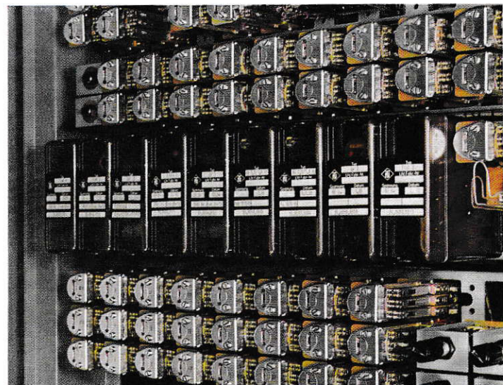
BILD 4 Teilansicht einer Fernwirkstation
