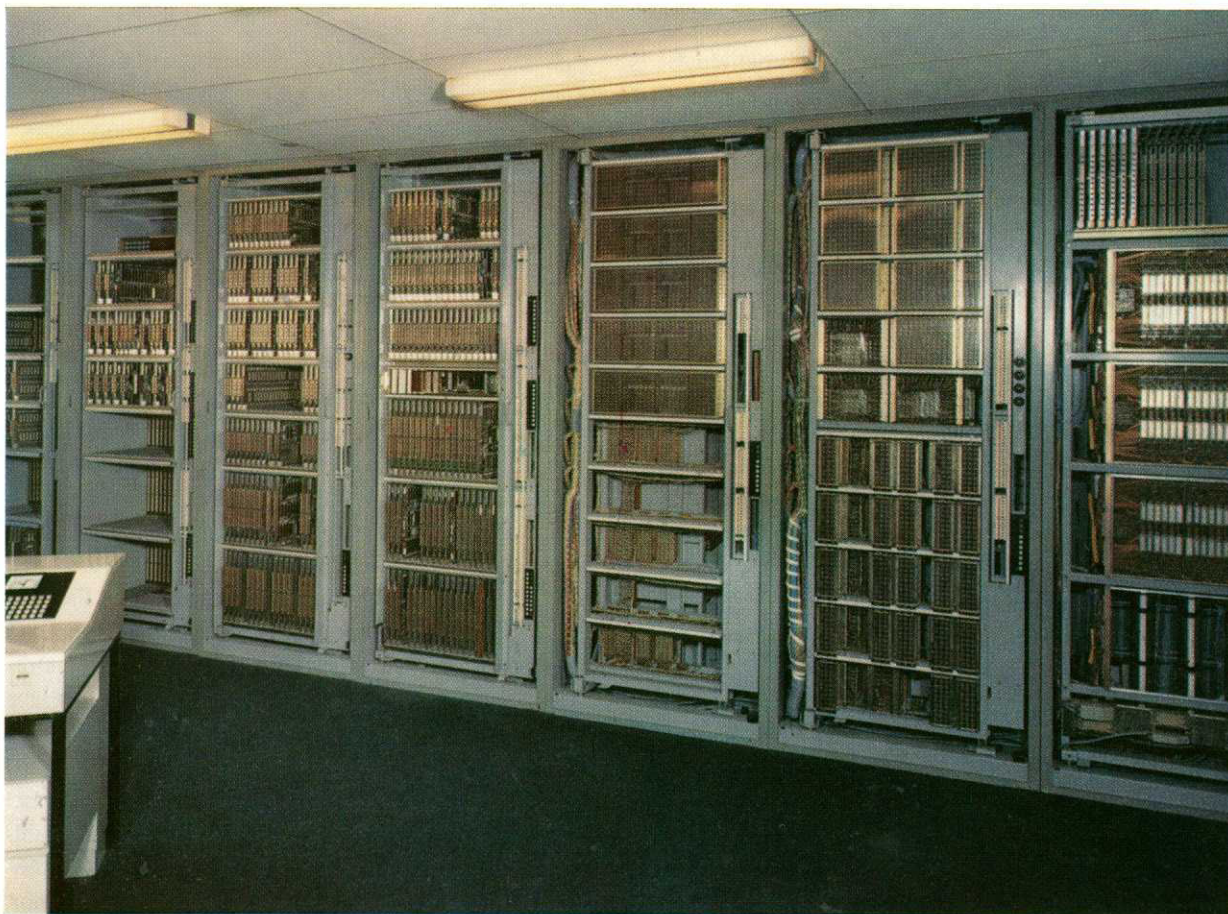
BILD 4 Große Multireed-Nebenstellenanlage III W 6020 (Türen entfernt)
